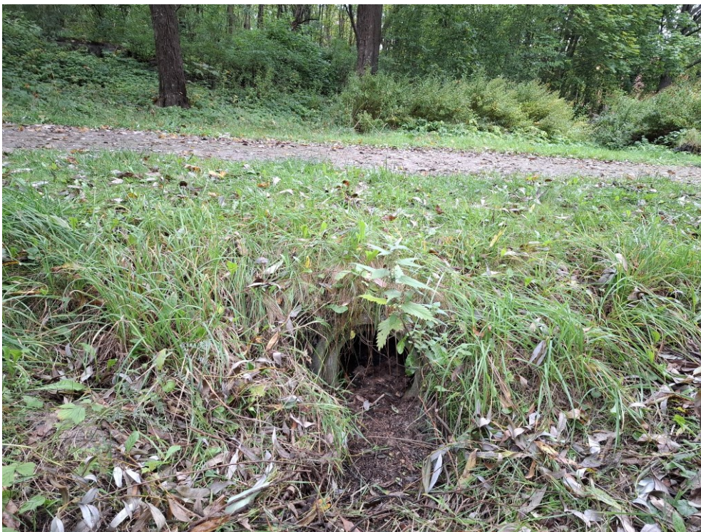
Kuva 3-8. Kaivosta lampeen päin johtava ylijäämäveden putki.
